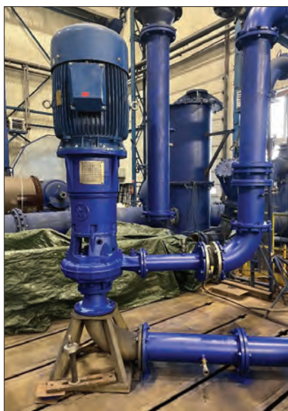
Figure 12. Tested pump with discharge and suction pipelines on the test rig Rysunek 12. Badana pompa z rurociągami: tłocznym i ssawnym
