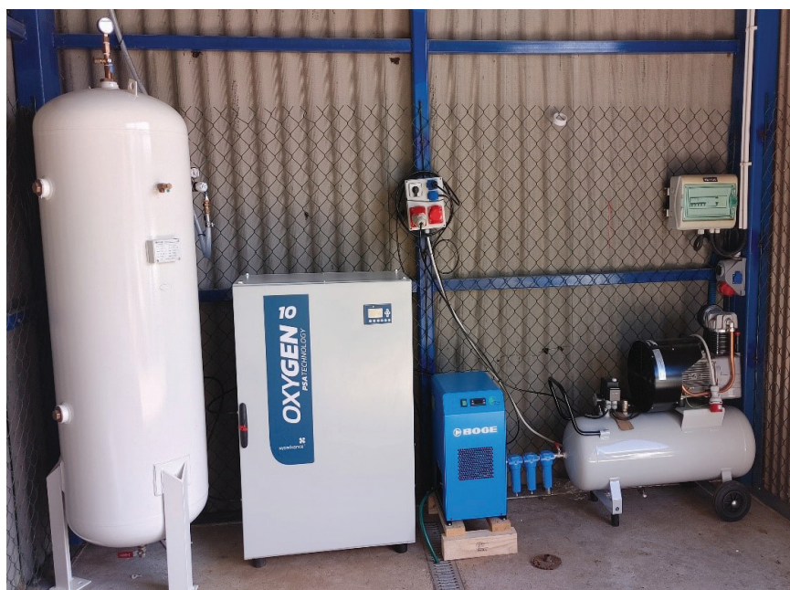
Rys. 2. Przedwdrożeniowa instalacja na obiekcie rzeczywistym Fig. 2. Pre-implementation installation at a full-scale facility
