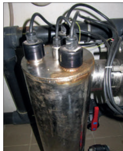
Fot. 2. Instalacja reaktora UV systemu niskociśnieniowego Pic. 2. UV reactor installation of low pressure system
