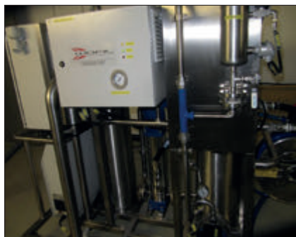
Fot.3. Mobilny system dezynfekcji wodą wysokoazotanową w podbaseniu Pic.3. Mobile disinfection system with highly ozonated water under the pool
