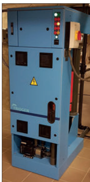
Fot. 5. Urządzenie UVAZONE w instalacji wody basenu w Przedszkolu B7 Pic. 5 UVAZONE device in pool water installation in Kindergarten B7
