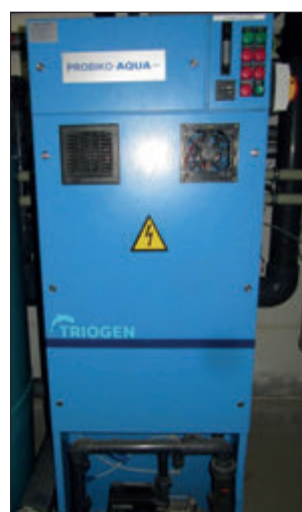
Fot. 4. Urządzenie UVAZONE w instalacji wody w małym basenie Pic. 4. UVAZONE device in small pool water installation
