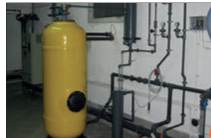
Fot. 1. Instalacja systemu ozonowania części strumienia Pic. 1. Installation for ozonation of stream part
