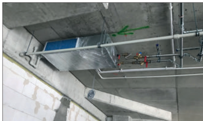
Rys.7. Pompa ciepła przyłączona do instalacji wodnej przez układ rurowy z zaworem regulacyjnym, filtrem siatkowym i zaworami odcinającymi
