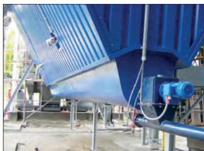
Rys. 10 Przenośnik spiralny zabudowany pod elektrofiltrem (ENTEX S.C.)
