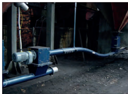
Rys. 9 Przenośniki spiralne połączone szeregowo ze zmianą kierunku transportu.(ENTEX S.C.)
