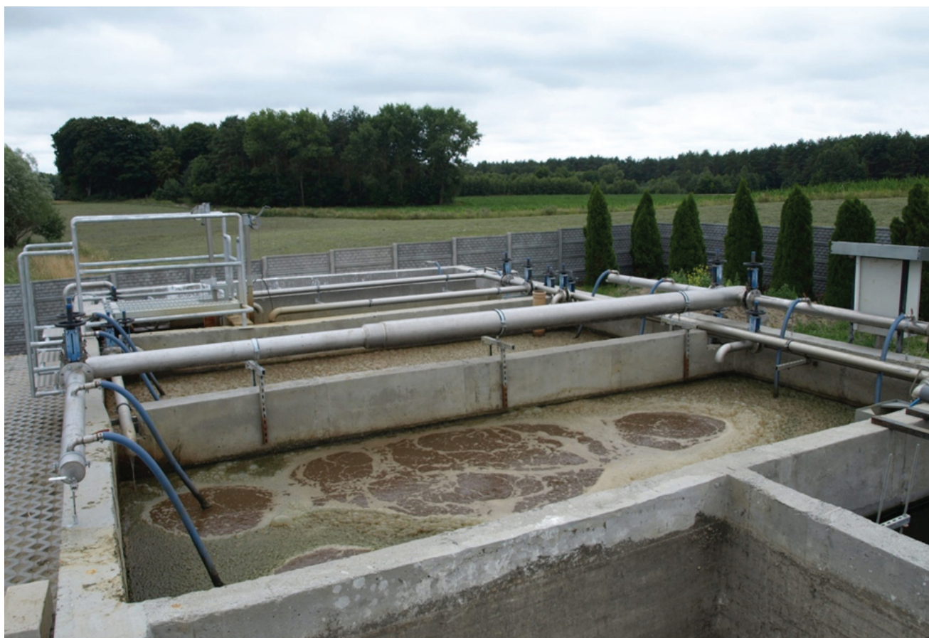
Rys. 2. Przykładowa oczyszczalnia ścieków w zakładzie przetwórstwa mięsa Fig. 2. Example of a sewage treatment plant at a meat processing plant
