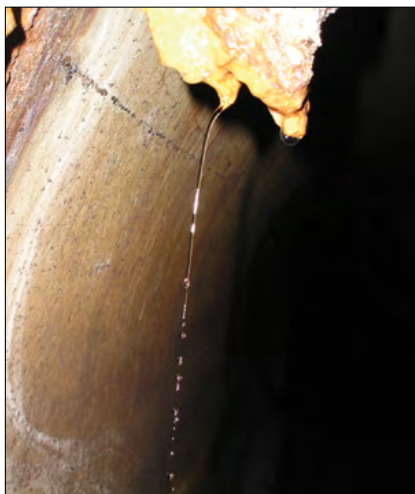
Rys. 3. Infiltracja wody gruntowej do wnętrza kanału z nieszczelnego złącza rur poprzez narost infiltracyjny [9] Fig. 3. Infiltration of groundwater into the sewer from leaking pipe joints through infiltration encrustation [9]
