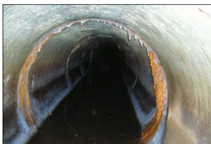
Rys. 4. Narost infiltracyjny na złączu rur [9] Fig. 4. Infiltration encrustation at the pipe joint [9]
