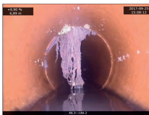
Fot. 7. Inspekcja kamerą CTV – wystające sznury uszczelniające rury kamionkowe. Pic. 7. CCTV inspection – protruding cords sealing on stone-ware pipes.
