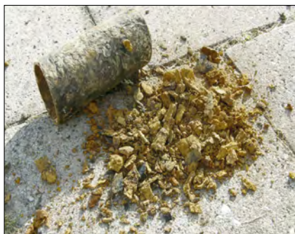
Fot. 2. Zawartość osadów w odcinku rury żeliwnej Ø100mm (bud. 1969 r.) Pic. 2. Deposits in cast iron pipe Ø100mm (building 1969)
