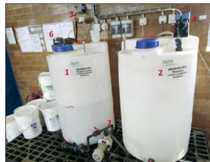
Fot. 4. Instalacja dozowania preparatu [7] Pic. 4. Dosing installation [7]
