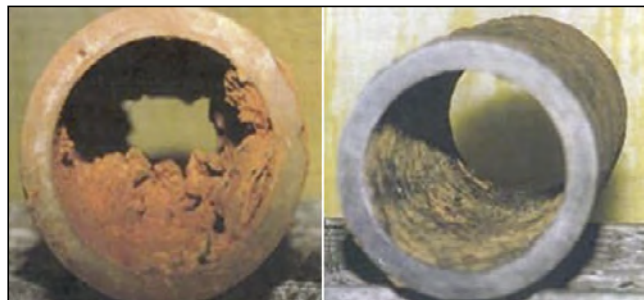
Fot. 6. Przykład efektu usunięcia osadów z rury stalowej pod wpływem działania fosforanów Pic. 6. Example of the effect of removing sediments under phosphates action in steel pipe
