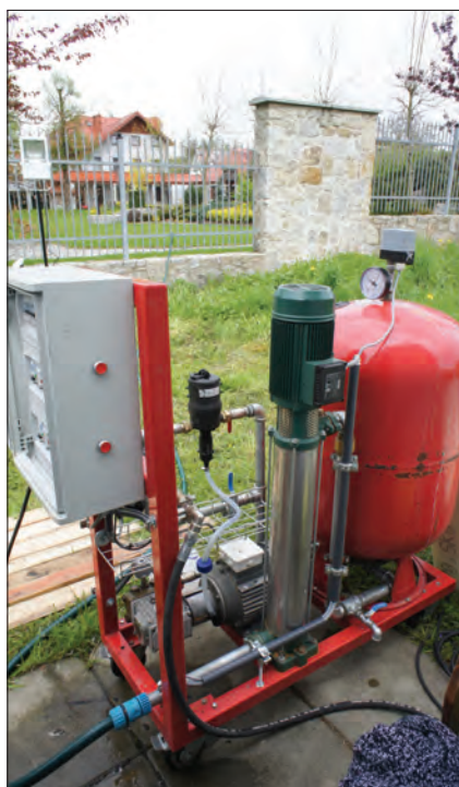
Fot.3. Zespół pompowy wraz ze zbiornikiem
