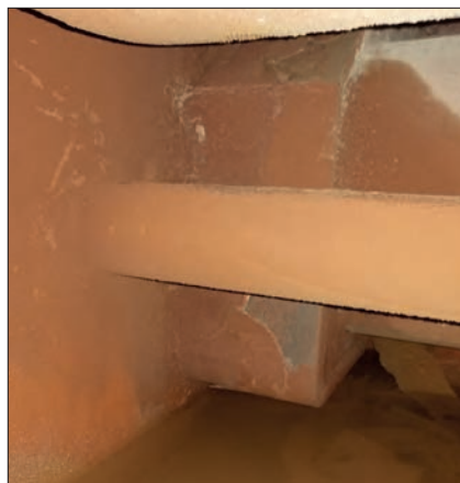
Fot. 2 Zanieczyszczenia warstwą twardego kalcytu komory nawrotnej kotła parowego
