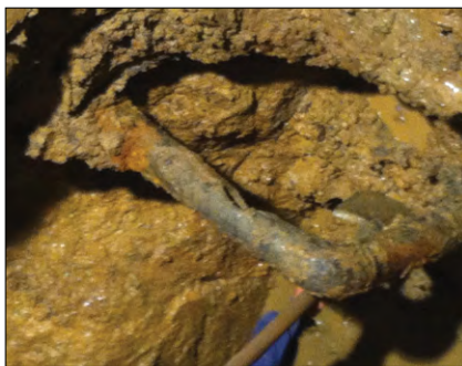
Fot. 5. Uszkodzenie przyłącza stalowego podczas wykonywania przecisku Pic. 5. Damaged steel connection during jacking works
