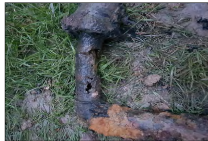
Fot. 1. Punktowa korozja, przyłączy wodociągowe Pic. 1. Point corrosion, water connection
