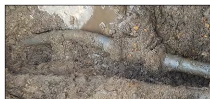
Fot. 4. Pęknięcie w rejonie trójnika w sieci rozdzielczej PVC Pic. 4. Pipe crack near tee in distribution network made of PVC
