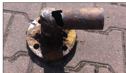
Fot.3. Punktowa korozja na kolanku Pic. 3. Point corrosion on elbow
