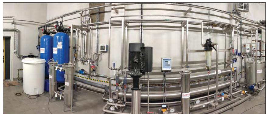
Rys. 5 Stacja RO przygotowania wody zdemineralizowanej do celów zasilania kotłowni pracującej w układzie kogeneracji. Na pierwszym planie widoczna dwustopniowa instalacja odwróconej osmozy z pompą ciśnieniową. Po lewej stronie widoczne kolumny zmiękczacza, wykorzystywane w przypadku awaryjnego zasilania RO wodą odżelazioną twardą
