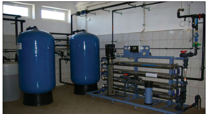
Rys. 4 Instalacja RO dla celów kotłowych. Woda jest wstępnie uzdatniana w filtrze węglowym, a następnie zmiękczaczu zanim wpłynie do instalacji membranowej
