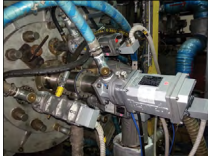
Rys. 2 Palniki olejowy i biomasy gotowe do montażu (u góry) oraz, palnik biomasy z palnikiem olejowym na stanowisku badawczym 0,5MW (na dole)
