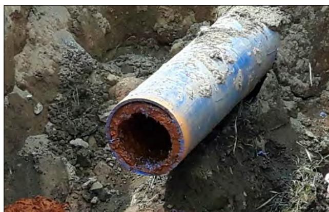
Rys. 7. Widok wnętrza rurociągu z PE po jego przecięciu
