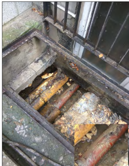
Rys.1. Awaria rurociągu zasilającego – widoczny wizerunek korozyjny (zdj. M. Chorzeński). Przyczyna awarii – nieszczelne przykrycie kanału. Rurociąg z przełomu lat 80 i 90 ub. wieku
