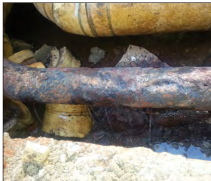
Rys.2. Awaria rurociągu zasilającego budynek mieszkalny. Widoczne bardzo silne skorodowania zewnętrzne i perforacja rury. Widoczne strugi wody ciekącej z otworów w dolnej części rurociągu. (zdj. M. Chorzeński). Przyczyna awarii – nieszczelne przykrycie kanału (pod parkingiem). Rurociąg z przełomu lat 80 i 90 ub. wieku
