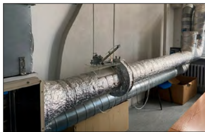
Rys. 2. Zdjęcie obrazujące układ przewodów powietrza zewnętrznego (przewód izolowany) oraz usuwającego powietrze z pomieszczenia. Fig. 2. The layout of the outside air ducts (insulated duct) and the exhaust air.
