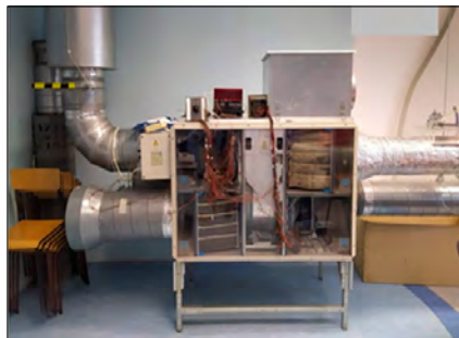
Rys. 3. Zdjęcie obrazujące centralę wentylacyjną nawiewno-wywiewną obsługującą pomieszczenia laboratoryjno-seminaryjne. Fig. 3. Photo showing the supply and exhaust air handling unit for both laboratory and seminar room.
