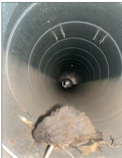
Rys. 6. Ptak w przewodzie wentylacyjnym wywiewnym od strony centrali. Fig. 6. The bird in the exhaust air duct on the side of the extract air.
