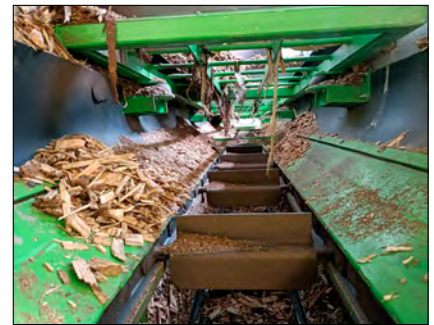
Fotografia 5. Element instalacji biomasowej - przenośnik skrobakowy paliwa Photo 5. Biomass installation component - fuel scraping conveyor
