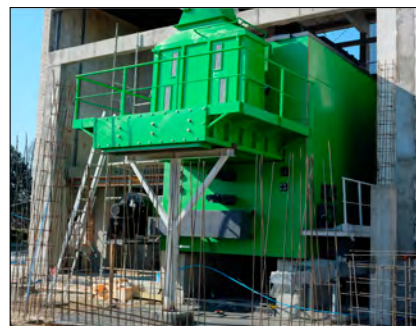
Fotografia 2. Element instalacji biomasowej - palenisko Photo 2. Biomass installation component - furnace
