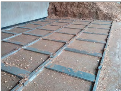
Fotografia 3. Element instalacji biomasowej - podłoga magazynu paliwa Photo 3. Biomass installation component - fuel storage floor
