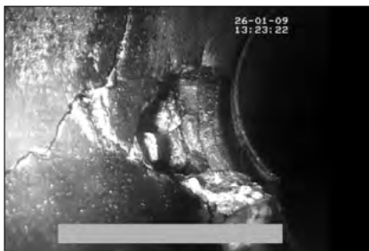
Rys. 12 Ubytki fragmentów powłok konstrukcji – w_u [11] Fig. 12 Losses of fragments of the structure coating – w_u [11]
