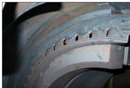
Rys.4. Uszkodzenia skrzynek dyszowych w trakcie drugiej awarii Fig.4. Damage to the nozzle boxes during the second failure
