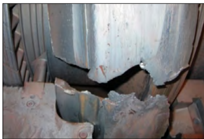
Rys.3. Uszkodzenia pierścienia kierującego w trakcie drugiej awarii Fig.3. Damage to the casting protection ring during the second failure
