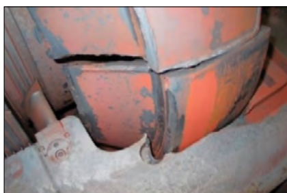
Rys.2. Uszkodzenia pierścienia kierującego w trakcie pierwszej awarii Fig.2. Damage to the casting protection ring during the first failure
