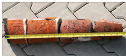
Rys. 2. Odwiert rdzeniowy ze sklepienia kolektora – grubość sklepienia 48 cm Fig. 2. Core bore from the collector's vault – vault thickness 48 cm
