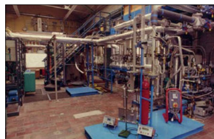
Rysunek 9. Stanowisko badawcze – testowana sieć grzewcza / chłodnicza [36] Figure 9. Test stand – tested heating/cooling network [36]
