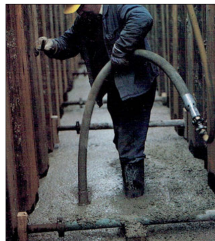
Rys. 4. Zagęszczanie betonu w wykopie ze stalowymi deskowaniami [1] Fig. 4. Concrete compaction in the trench with steel formwork [1]
