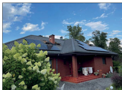
Fig.6. PV units installed on the roof – west side (pic. Ewelina Różycka-Wrońska) Rys.6. Jednostki fotowoltaiczne zamontowane na dachu – strona zachodnia (fot. Ewelina Różycka-Wrońska)
