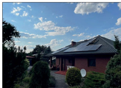
Fig.5. PV units installed on the roof – east side (pic. Ewelina Różycka-Wrońska) Rys.5. Jednostki fotowoltaiczne zamontowane na dachu – strona wschodnia (fot. Ewelina Różycka-Wrońska)
