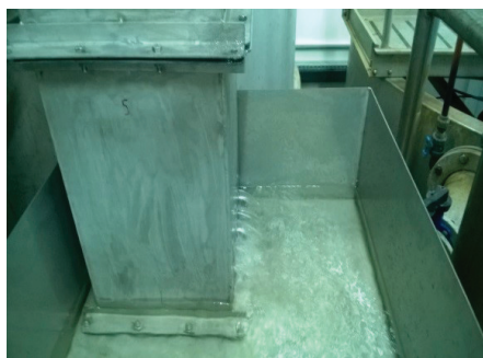
Rys. 2. Aerator do napowietrzania wody Fig. 2. Aerator for aerating water
