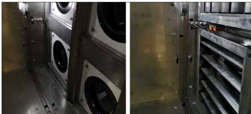
Rys. 1. Zespół wentylatorów w centrali wentylacyjnej [12], odpowiednio bez przepustnic oraz z zainstalowanymi przepustnicami na każdym wentylatorze Fig. 1. The fan array in AHU [12] without and with air dampers on each fan
