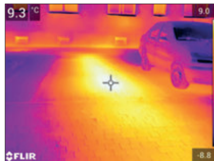
Rys. 6 Wygrzanie gruntu nad siecią ciepłowniczą w miejscu wycieku Fig. 6. Increased temperature of the ground above
