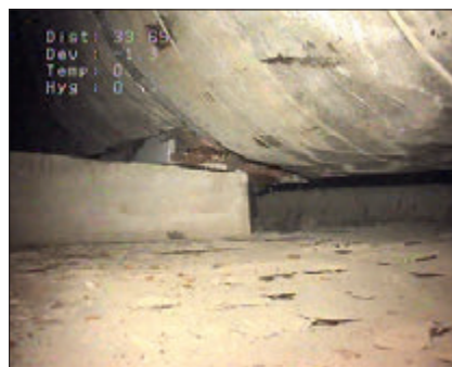
Rys. 1 Zsuniecie podpory rurociągu z betonowej podstawy Fig. 1. Pipeline support deployment
