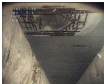
Rys. 2 Defekt żelbetowego stropu kanału Fig. 2. Defect of channel ceiling
