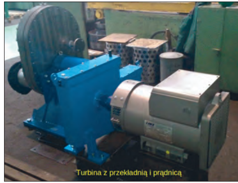
Rys. 5 Widok całego agregatu turbiny systemu Elektra
