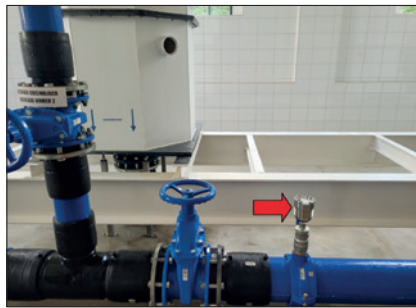
Rysunek 3. Zabudowa rejestratora przed kaskadami napowietrzającymi w SUW (zdjęcie autora) Figure 3. Pressure data logger installed in water treatment plant (SUW)
