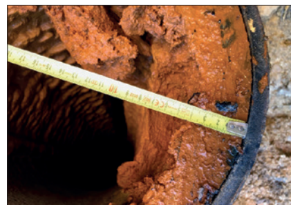
Rysunek 9. Zdjęcia wnętrza rurociągu z PVC przed jego czyszczeniem (udostępnione przez firmę Tukany sp. z o.o., Jelenia Góra, Polska) Figure 9. Iron residue inside a PVC pipe before mechanical cleaning (images shared by Tukany LLC, Poland)
