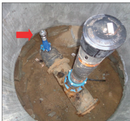
Rysunek 2. Zabudowa rejestratora w komorze odpowietrznika nr 1 (zdjęcie autora) Figure 2. Pressure data logger installed in automatic air vent chamber no. 1
