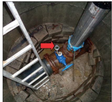
Rysunek 5. Zabudowa rejestratora w komorze odpowietrznika nr 2 (zdjęcie autora) Figure 5. Pressure data logger installed in automatic air vent chamber no. 2 (Keller Leo5)
