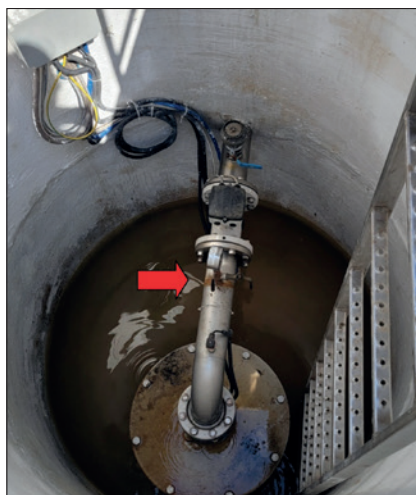
Rysunek 4. Zabudowa punktu pomiaru ciśnienia w studni UJ10 (zdjęcie autora) Figure 4. Pressure data logger installed in deep well no. 10 (UJ10)
