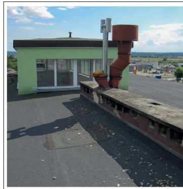
Rys. 4. Dach jednego z analizowanych budynków i szkielet z usytuowania zespołów pomp ciepła na dachu
